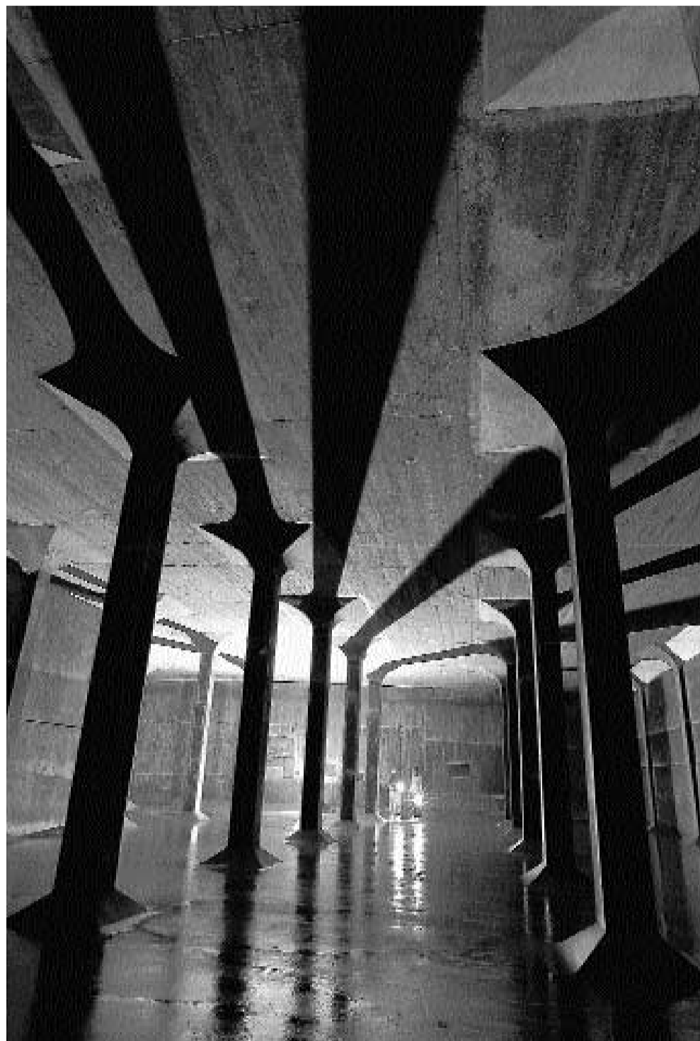
Riesige Ausmasse: Eine der fünf Kammern im Wasserreservoir Mannenberg in Ittigen. A. MOSER
